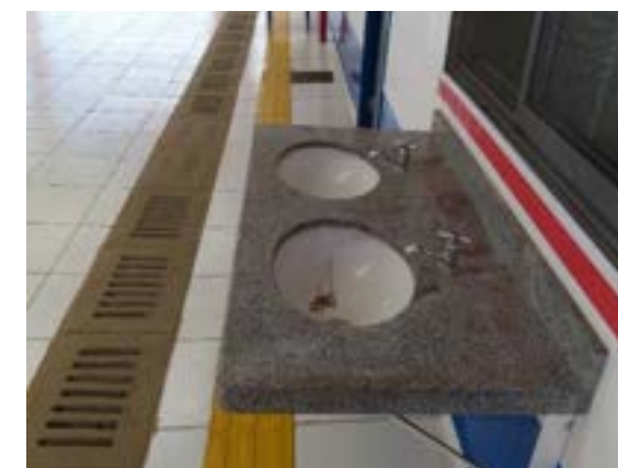
Figura 25. Defeitos constatados na obra em Anápolis (GO)
