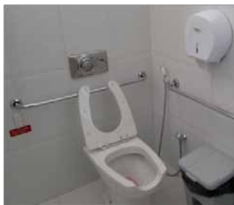
Foto 1 Exemplo de banheiro acessível destinado a pessoas com deficiência
